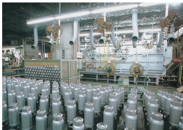
図 6.10 チップ管式排気設備外観 6)
