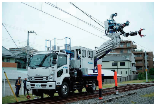
図 6.12 多機能鉄道重機の外観 (写真提供：西日本旅客鉄道株式会社／日本信号株式会社)
