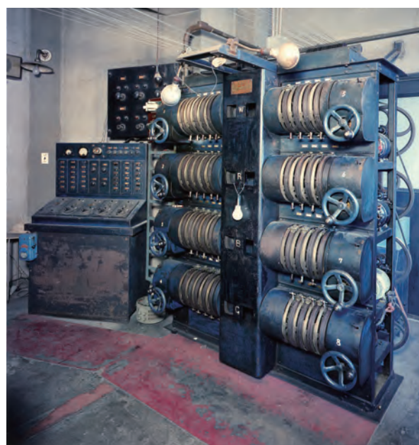
図 10.4 弥栄会館に設備されていた U 型調光操作盤
