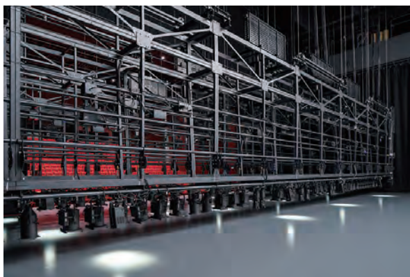
図 2.39 照明ブリッジとサスペンションスポットライト 39)
