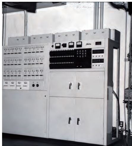
図6.2 調光ユニット収納ラック 2)
