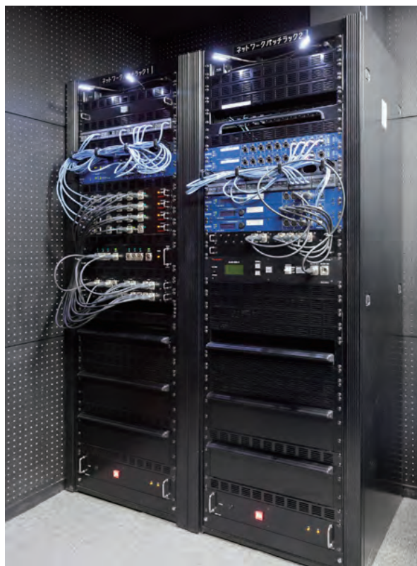
図 2.18 ネットワークパッチラック 18)
