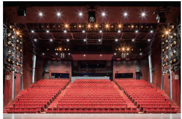
図 2.40 舞台から見た舞台照明設備 40)
