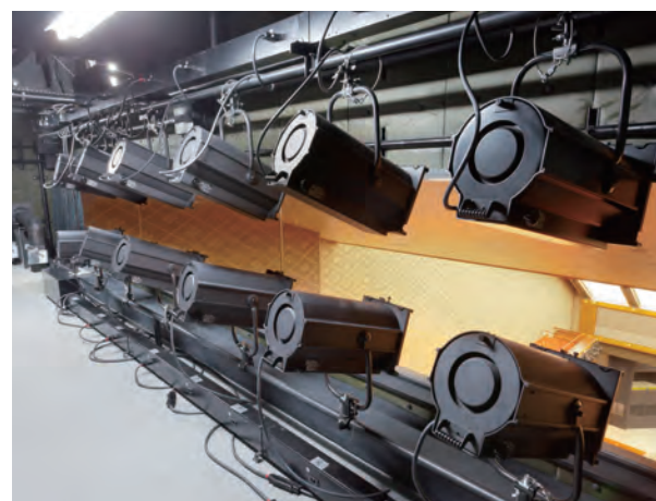
図 2.11 シーリングスポットライト室の内部 11)
