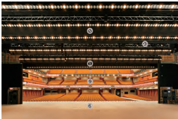
図 2.8 舞台上部の舞台照明設備 8)
