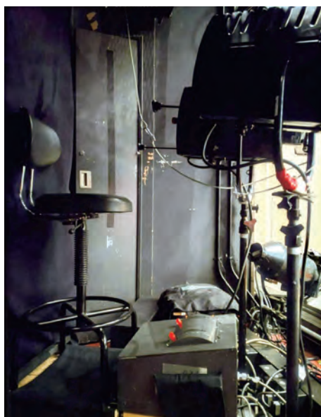
新橋演舞場のフォロースポットライト操作室。オペレータは椅子に座り、2台のスポットライトを両手で操作しながら、足元の「ケトバシ」のフェーダを足の指先で動かして、調光操作をおこなっていた。
