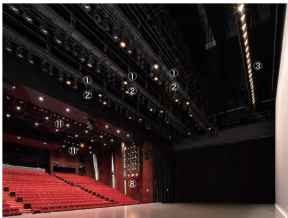
図 2.38 舞台上部の舞台照明設備 38)
