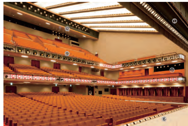
図 2.9 客席側からの前明かりをつくる照明設備 9)
