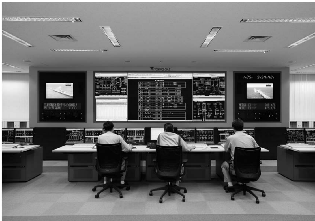
図8.17 LNGプラント中央制御室 (15)
