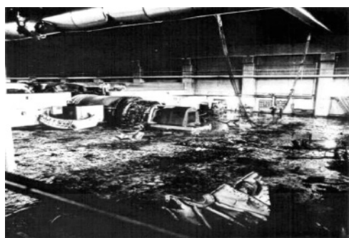
図6.5 運転中の発電機のエンドリング破壊事故例(欧州)
