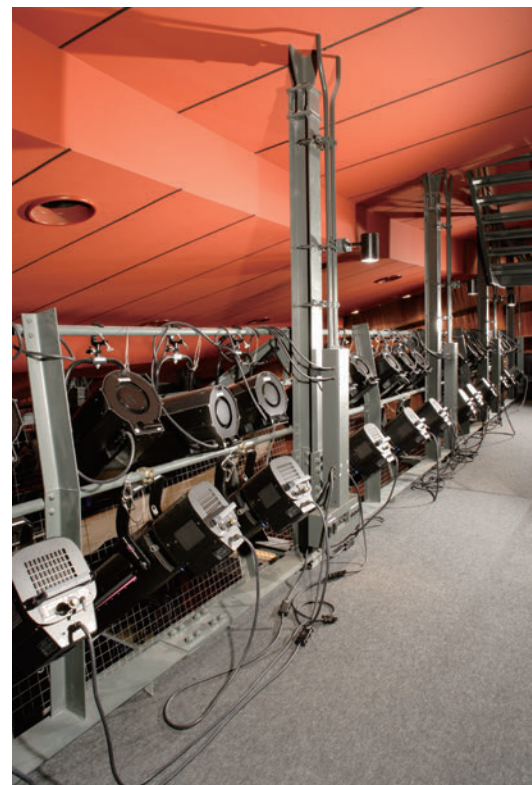
図 3.10 シーリングスポットライト (いわきアリオス)
