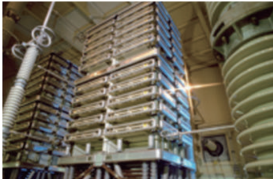
図 4.5 電源開発北本連系函館変換所 GTO サイリスタ変換装置 (1979) (掲載許諾) 15)
