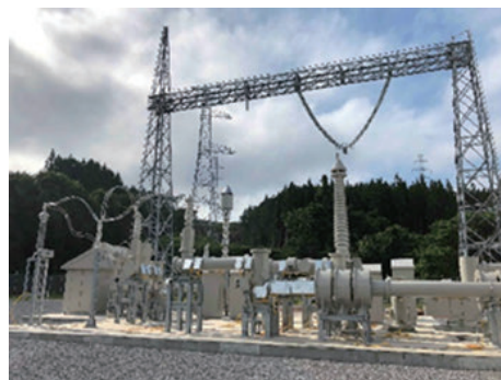
図 4.35 北海道電力北斗変換所納東芝製 250 kV DC-GIS (2019) (掲載許諾) 49)
