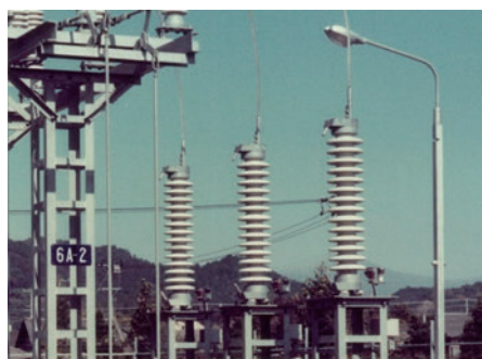
図 3.4 九州電力隼人変電所納明電舎製 66 kV 酸化亜鉛形避雷器(世界初)(1975)(掲載許諾) 7),8)
