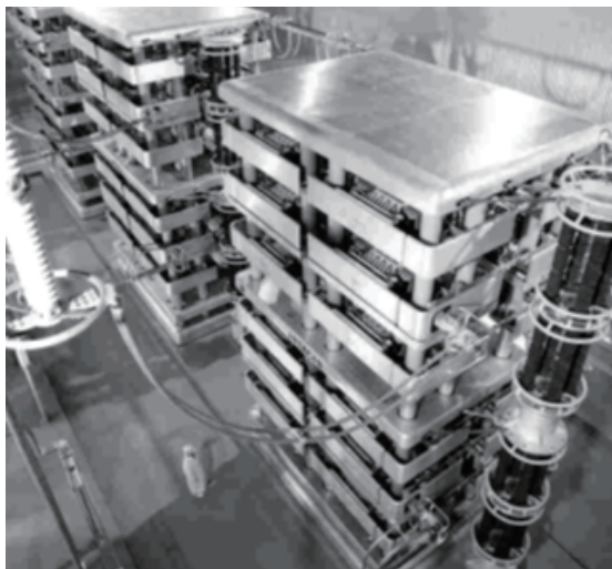
図 4.7 関西電力紀北変換所 GTO サイリスタ変換装置 (2000) (8 kV-3500A 光トリガー式サイリスタ素子を採用) (掲載許諾) 17)
