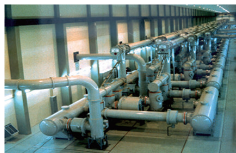
図 3.56 南アフリカ ESKOM BETA 変電所納東芝製 800 kV GIS (1985) (東芝提供)
