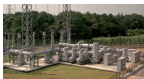
図 3.54 東京電力新坂戸変電所納東芝製 300 kV 全三相一括形 Full-GIS (1989) (掲載許諾)
