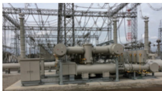
図 3.67 東京電力新佐原変電所納東芝製 550 kV 主母線三相一括相分離形 Full-GIS (2019) (掲載許諾)
