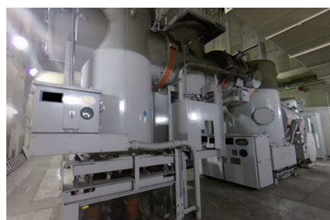
図 3.55 中部電力下広井変電所納日立製作所製 300 kV 全三相一括形 Full-GIS (1992) (掲載許諾)
