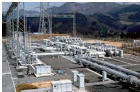
図 3.63 東京電力西群馬開閉所納東芝製 550 kV 主母線三相一括相分離形 Full-GIS (1991) (掲載許諾)
