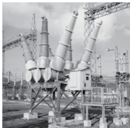
図 2.48 204/168 kV-40 kA タンク形真空遮断器(2012)(明電舎提供) 51)
