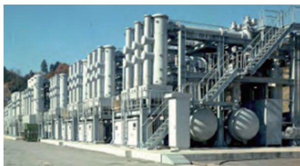
図 3.52 東京電力新多摩変電所納東芝製 300 kV 50 kA 相分離形 Full-GIS (1974) (掲載許諾)
