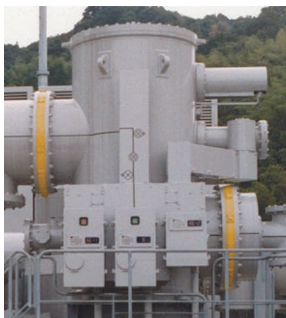
図 4.34 四国電力阿南変換所納東芝製 500 kV DC-GIS (断路器・接地開閉器) (掲載許諾)
