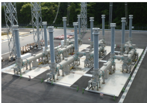
図 3.69 関西電力金剛変電所納三菱電機製 550 kV H-GIS ばね操作 CB 適用 (2016) (掲載許諾) 24), 30)
