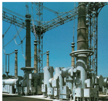
図 3.5 九州電力西九州変電所納三菱製 550 kV タンク形酸化亜鉛形避雷器(1978)(掲載許諾)
