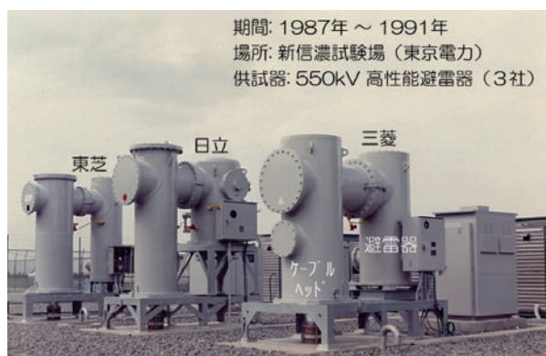
図 3.12 東京電力新信濃変電所における 550 kV タンク形避雷器の試験状況 (掲載許諾) 9)
