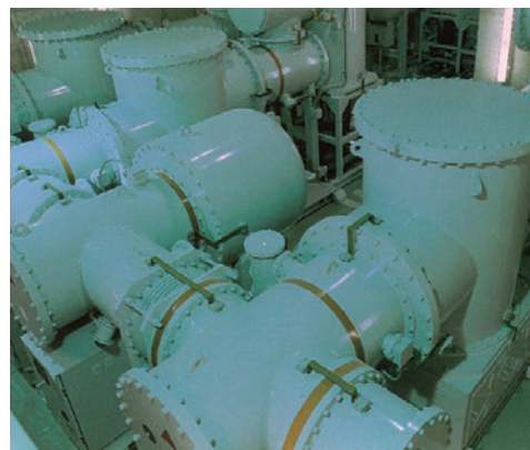
図 3.50 中部電力南武平町変電所納三菱電機製 300 kV 全三相一括形 Full-GIS (1988) (掲載許諾)
