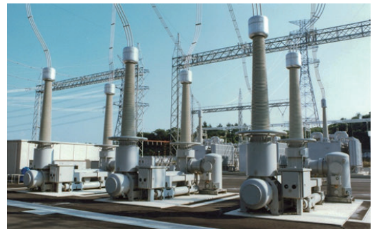
図 2.65 東京電力新榛名変電所納日立製作所製 550 kV 四点切タンク形ガス遮断器 (1981) (掲載許諾)
