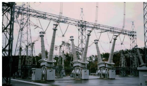
図 2.68 中国電力（現・中国電力ネットワーク）新山口変電所納三菱電機製 550 kV 一点切タンク形ガス遮断器（1995）（掲載許諾）
