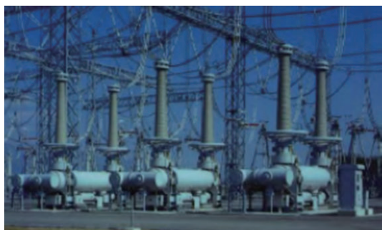
図 3.61 東京電力新信濃変電所納東芝製 550 kV H-GIS (1978) (掲載許諾)
