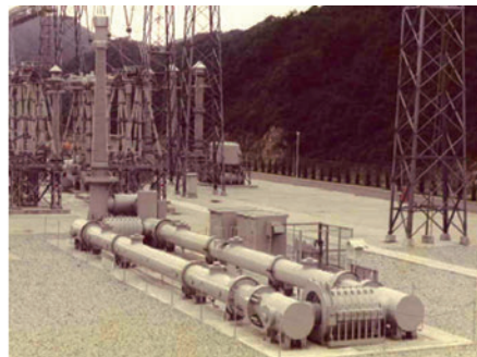
図 3.58 550 kV ガス絶縁母線の長期課電試験 (1974-76) (掲載許諾)
