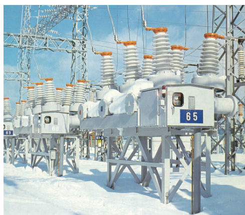
図 2.47 84/72 kV-25 kA タンク形真空遮断器(明電舎提供) 50)
