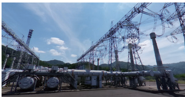
図 3.64 中部電力岐阜開閉所納日立製作所製 550 kV 主母線三相一括相分離形 Full-GIS (1996) (掲載許諾)
