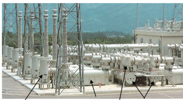
図 3.65 中部電力殿新三河変電所納三菱電機製 550 kV 主母線三相一括相分離形 GIS (1982) (掲載許諾) 22), 29)
