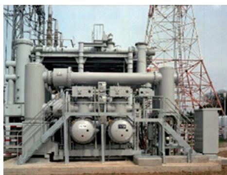
図 3.53 東京電力花見川変電所納東芝製 300 kV 主母線三相一括相分離形 Full-GIS (1982) (掲載許諾)
