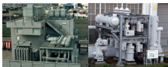
図3.40 (左)東京電力西堀変電所における66 kV-2.5 GVA GISの実運用を開始(1969)、(右)当該GISは27年運用後、現在は東芝・浜川崎工場に展示中(東芝提供)
