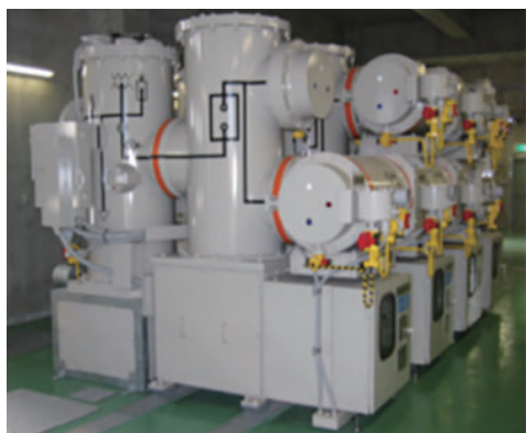
図 3.47 九州電力周船寺変電所納東芝製三相一括複合形 72 kV GIS (1997) (掲載許諾)
