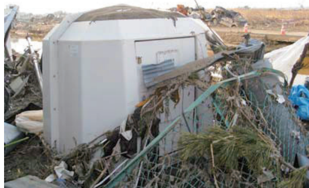
(b) 被災状況 (近景：機器収納箱に津波の痕跡があるが移動はしていない)
