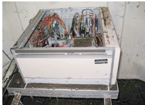
(d) 被災状況 (機器内部：内部にも泥が入っている)
